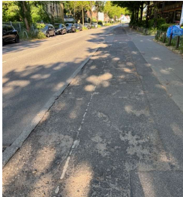
Radweg in sehr schlechten Zustand
